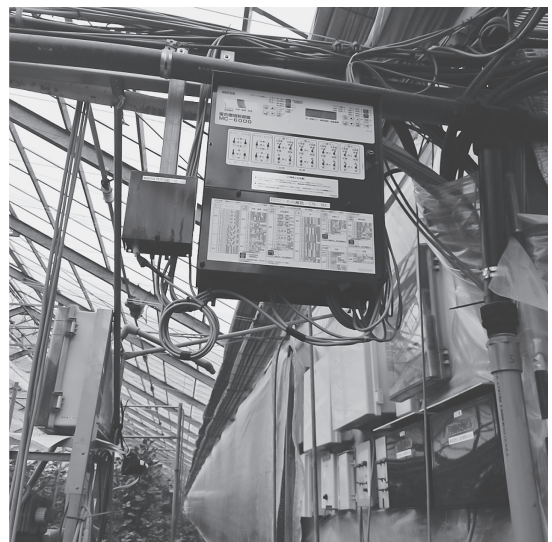
導入設備：複合環境制御システム
